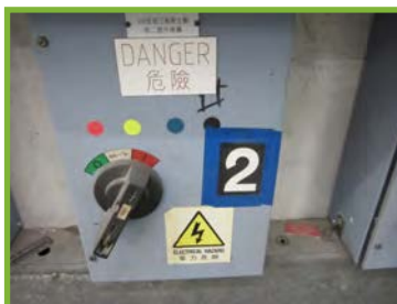
圖 13 (8.8.4): 在電源開關的位置，貼上「電力危險」的警告標語
