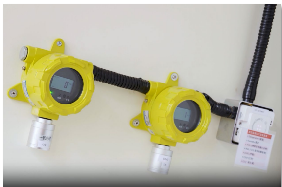
室內空氣質素監測系統
