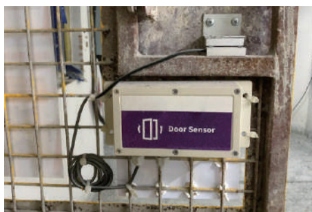
危險區域進出管制 (電子鎖系統)
