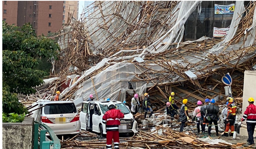
樂活道塌棚架 | 打風下進行工程 1工人被壓死
